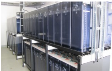
Batería Estacionaria BAE 16 PVS 3040
